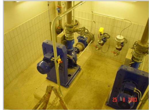
Aufstellung der Pumpen
