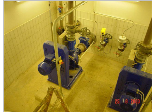
Aufstellung der Pumpen
